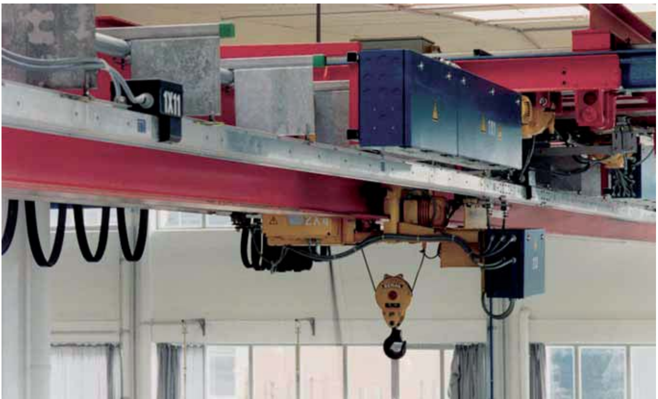
Sicherheits-Schleifleitung LSVG an einer Kranbrücke.
