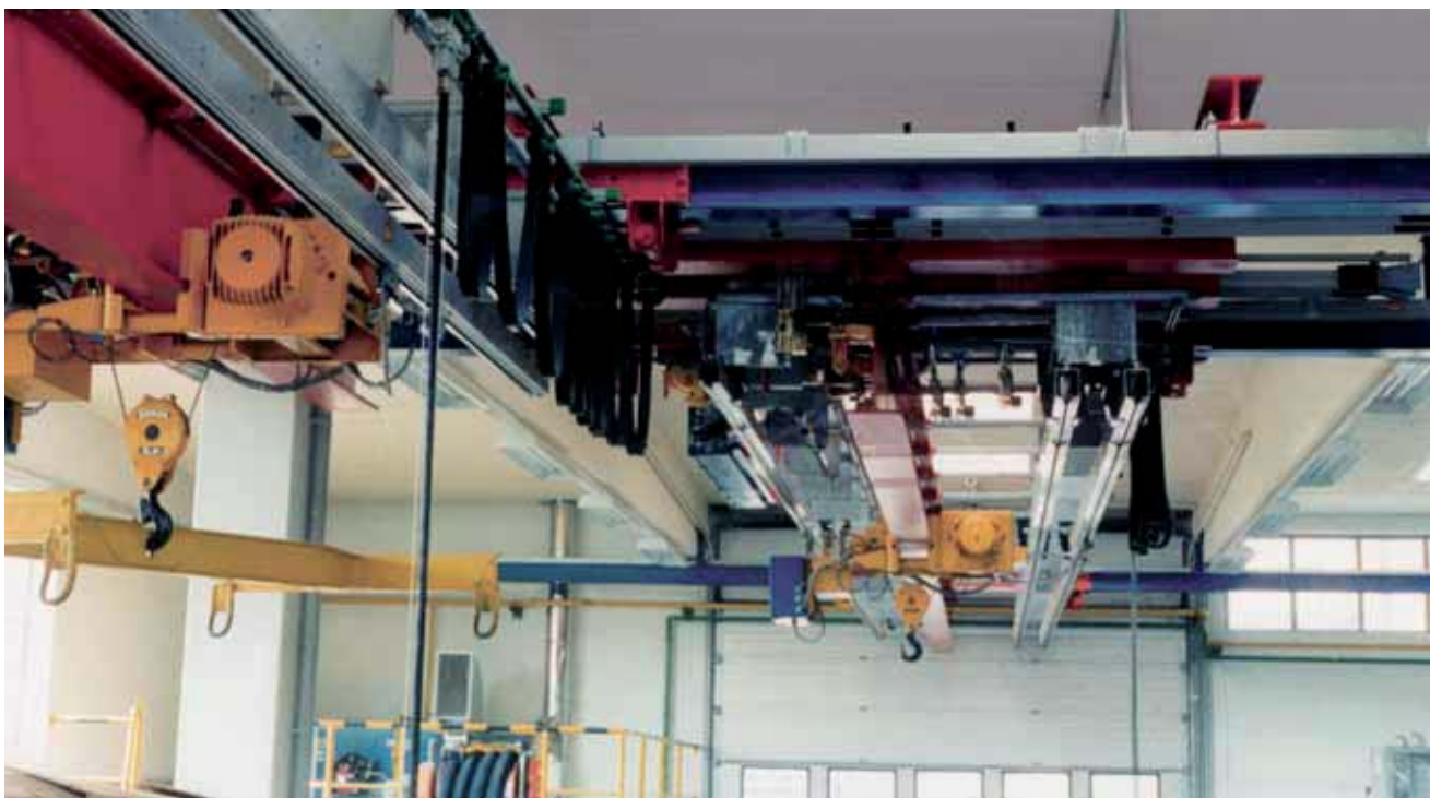
Sicherheits-Schleifleitung an einer Kranbrücke.
