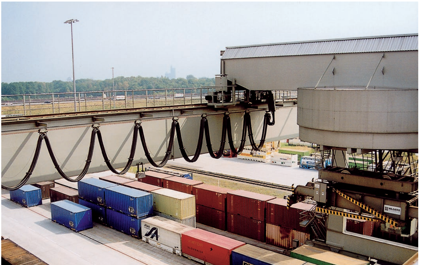
Leitungswagenanlage an einem Containerkran
